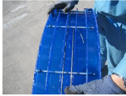
リングに組み立てた3Sセグメントの背面に補強鉄線を取付
